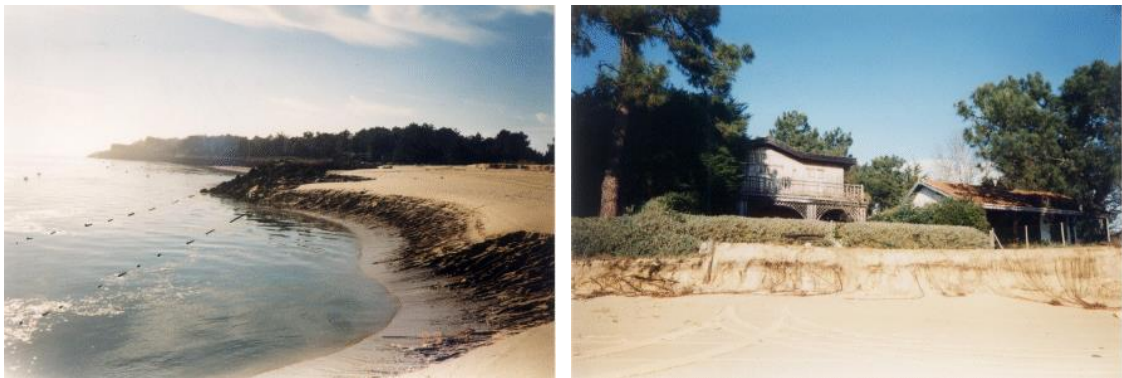
Figure 44. Photographies de l'effondrement du 04 janvier 1999 au droit de la propriété de M. Vidalis (source : SOGREAH, 2003).
