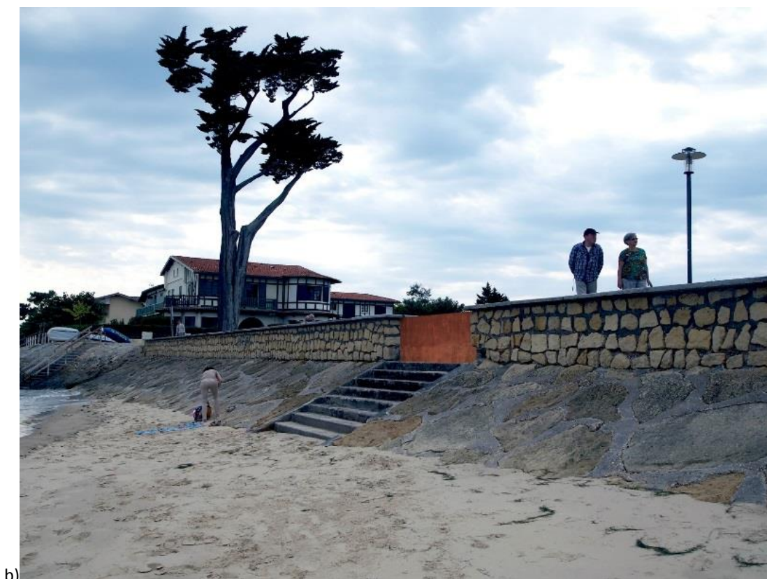
Figure 87 : Visualisation de la protection anti-submersion d'un perré du secteur de Bélisaire selon le scénario 3 a) en 2016 – b) Après pose d'un batardeau anti-submersion.
